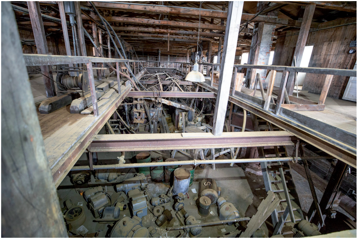
Flotasjonshallen sett fra sør, øvre dekk med blikk ned mot tønner, motorer og annet løsøre som bør ryddes.
